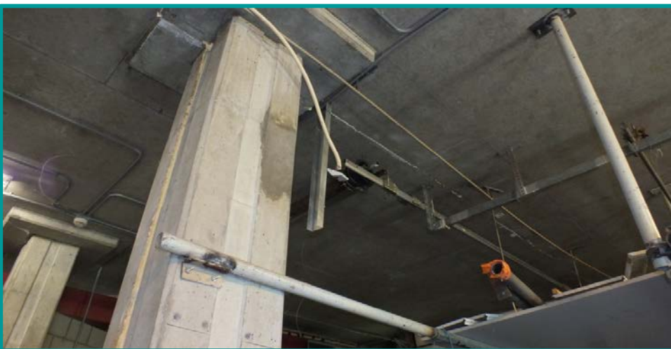
Foto : nevenindicator die hangt aan zijn bekabeling
