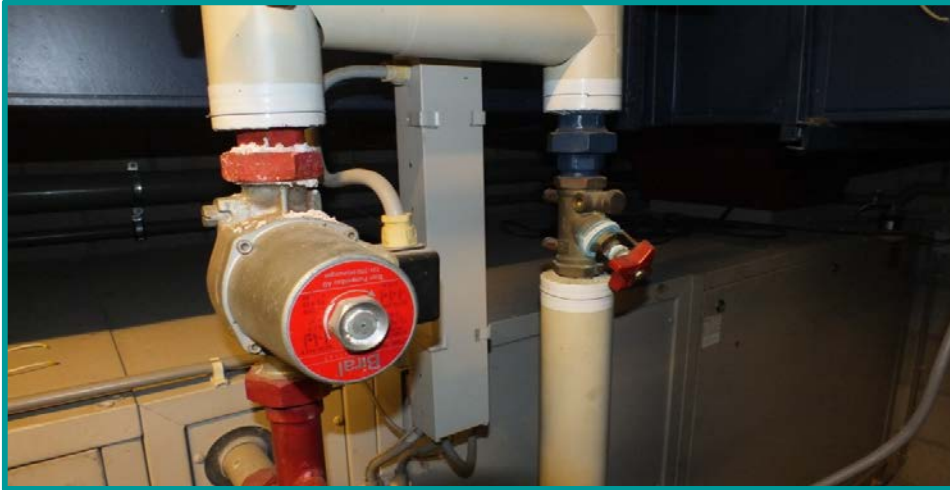
Foto : corrosievorming bij appendages
