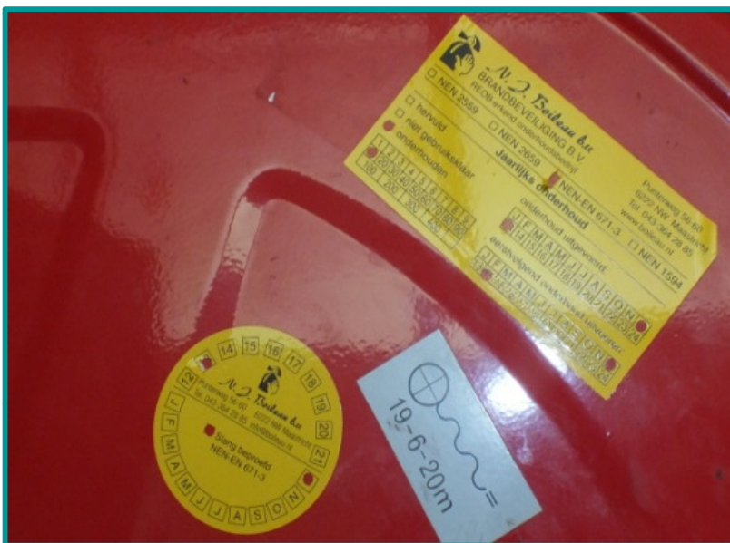
Foto: keuringsdatum brandslanghaspel
