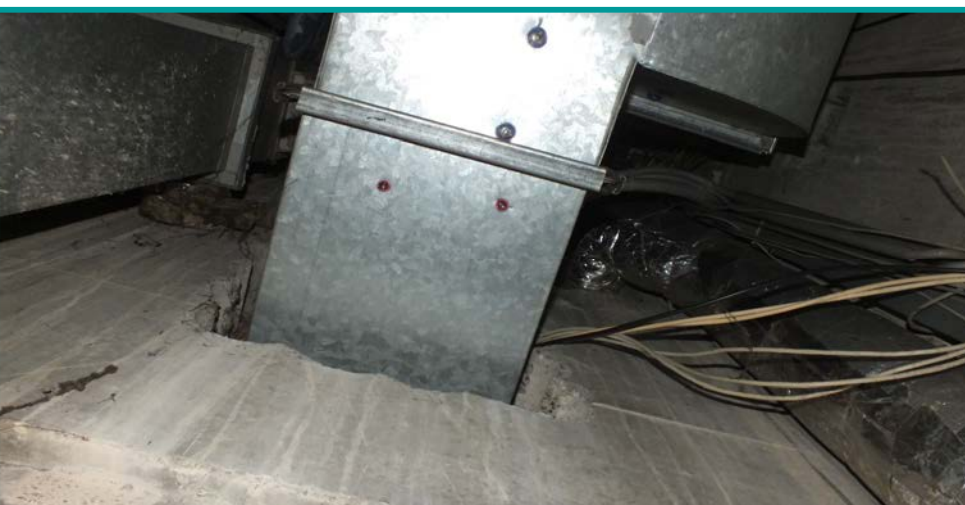
Foto : ontbreken brandklep bij doorvoering door schachtwand
