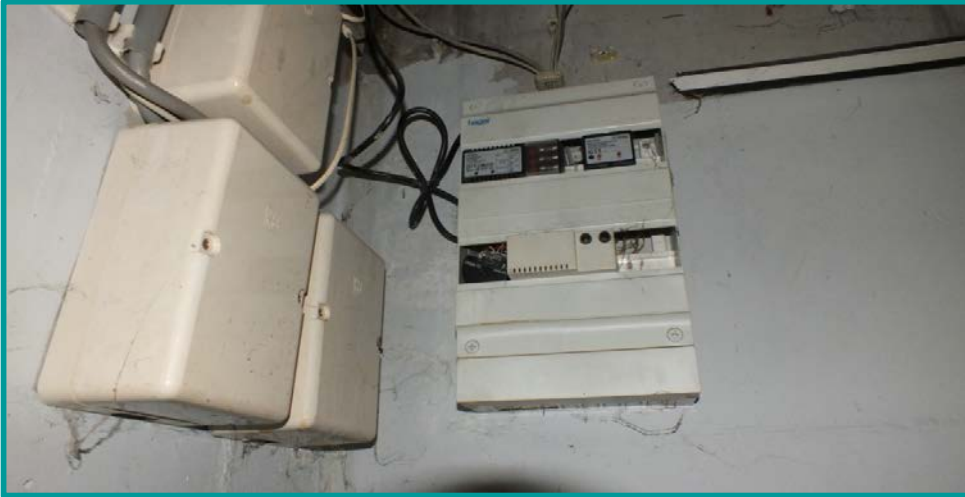
Foto : verdeler met deels ontbrekende afdekking
