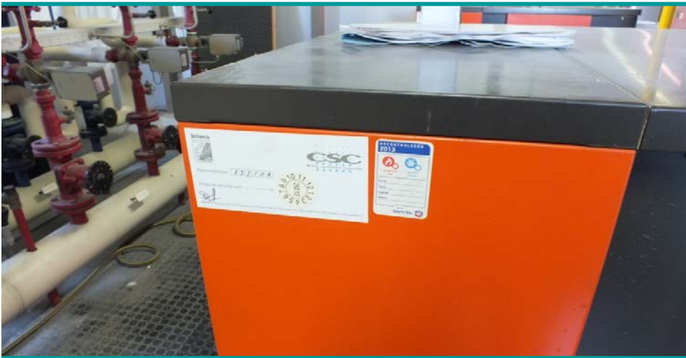
Foto : ketel met sticker onderhoud uit 2013.
