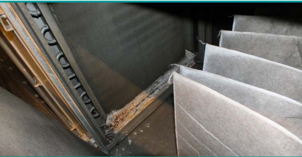
Foto : vergaande corrosievorming bij een verwarmingsbatterij
